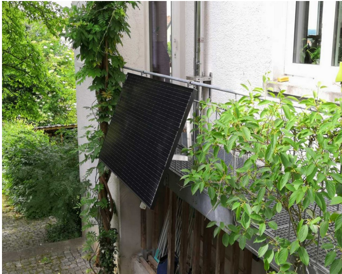
Abb. 01: Am Balkongeländer mit 25°-Neigung montiertes Solarmodul
